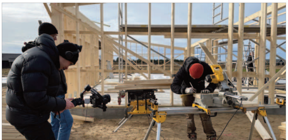
Film ab in Dänemark: Anton Fröhlich arbeitet als Tischler an dem Bau eines Holzhauses mit. Foto: Peggy Michel
